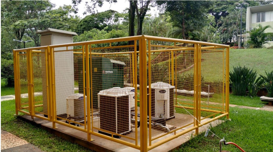
Figura 30 - CLIMATIZAÇÃO DOS AMBIENTES: Ar Condicionado
