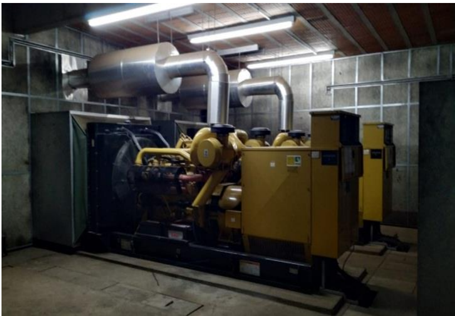
Figura 35 - Gerador de Energia Elétrica – Manutenções Mensais Preventiva
